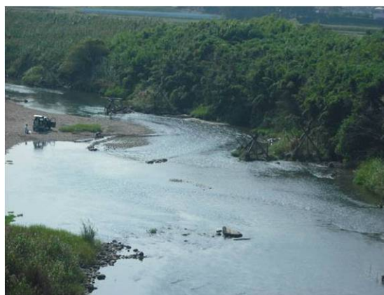
良好な景観の形成に役立っている水制工の例 (西都市)
