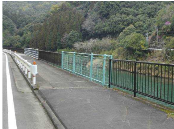
一体的に改修がなされなかったため、違和感が生じている例
