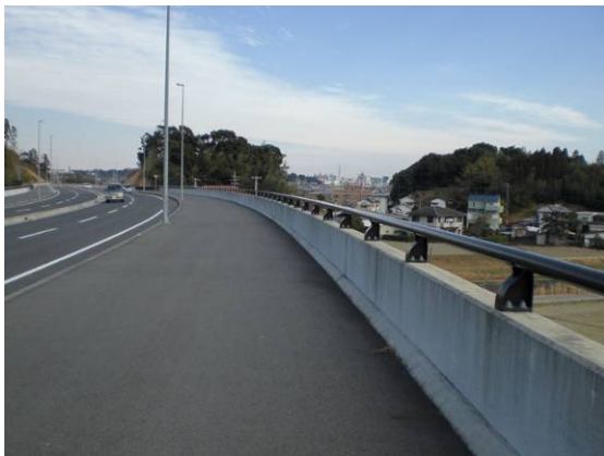
コンクリート製の壁型剛性防護柵の上部に金属製のトップレールを付加した複合型とし、防護柵の存在感を低減させている例（宮崎市）
