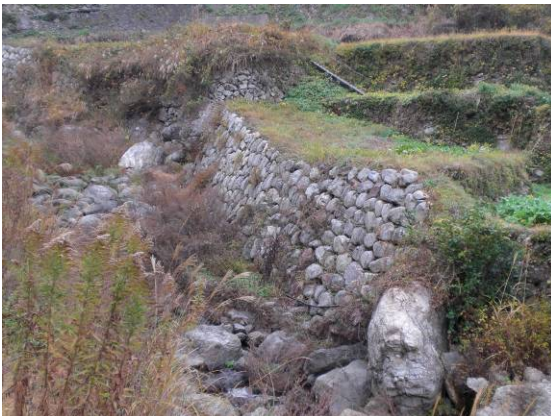
天端コンクリートが見えないよう工夫した例（高千穂町）
