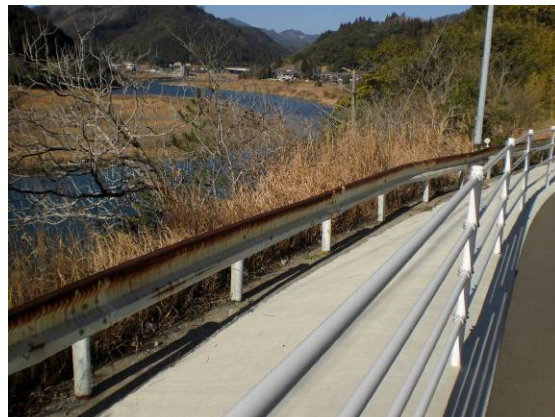
道路改築により残った不要な防護柵の例
