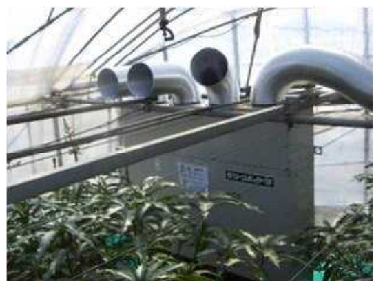
○ ヒートポンプの導入
