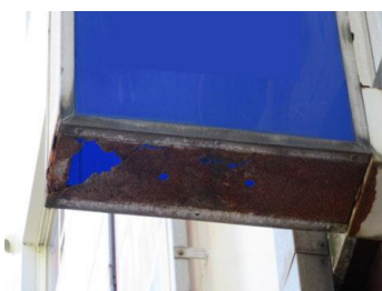
側板底面が腐食、破損した状態
