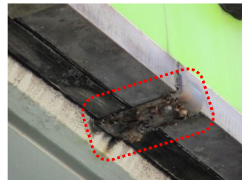
金具が劣化した状態
