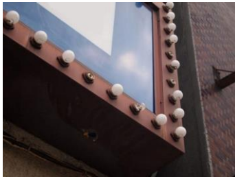
照明の不点灯
