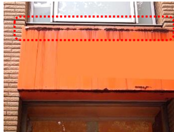
その他（塗装剥離、腐食など）
