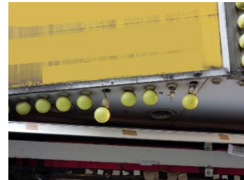
照明器具の傾き、外れ
