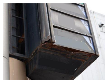
側板底面が腐食、破損した状態
