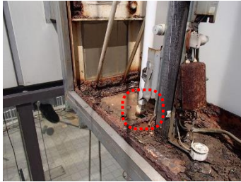
蛍光灯のホルダーが破損した状態
