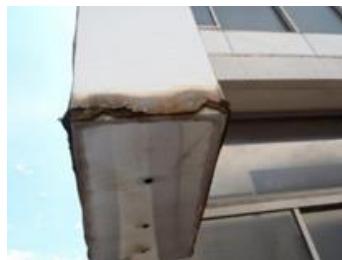
広告板底部の腐食
