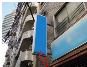
振れ止め棒が変形した状態
