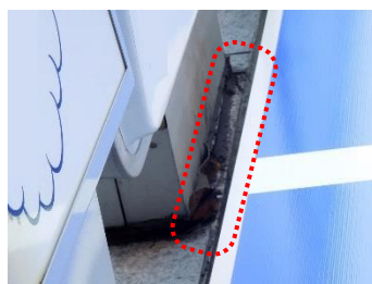
コーキングが劣化した状態
