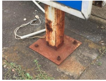
支柱根元の腐食、支柱と基礎部分・根巻きに生じた隙間、支柱ぐらつき
