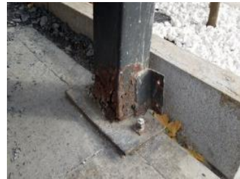
支柱根元の腐食が進行した状態
