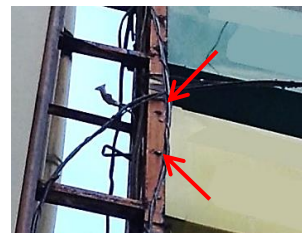
ボルトのゆるみや欠落した状態
