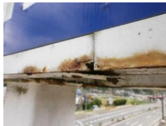
その他（塗装剥離、腐食など）
