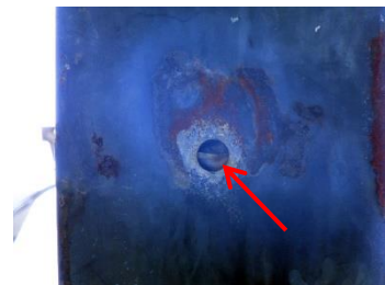
水抜き孔の詰まり
