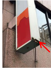
広告板底部の腐食が進行した状態
