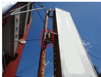
支柱・広告板接合部の腐食・隙間
