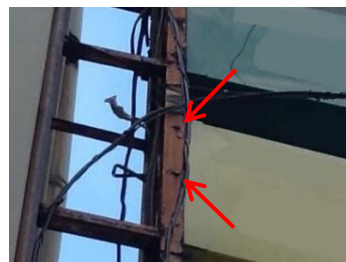
ボルトのゆるみや欠落した状態
