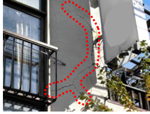
壁面にひびが生じた状態
