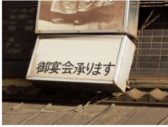
屋外広告物本体の傾き
