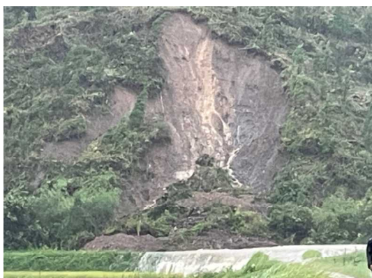
RO4災 河川災害復旧工事（西の園川） 被災状況（河川埋塞）
