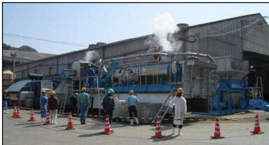
(移動式レンダリング装置全体)
