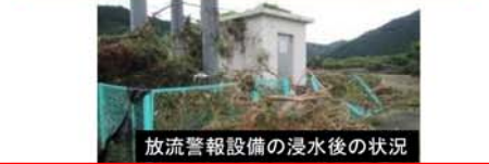
放流警報設備の浸水後の状況
