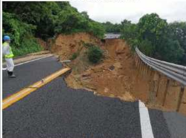
道路の被害 (広島県安芸郡坂町 広島呉道路)
