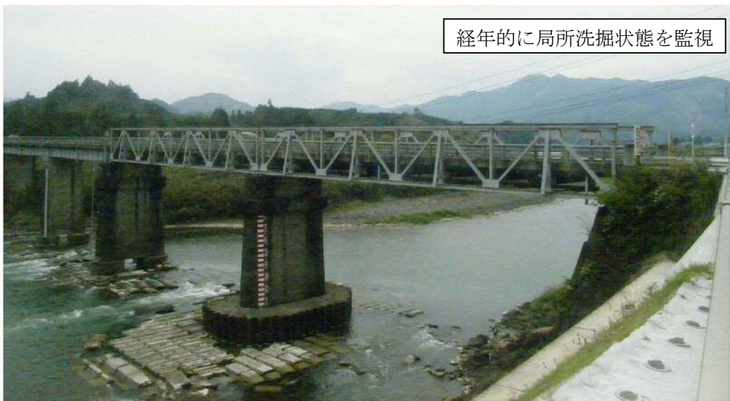
写真－東郷橋の橋脚の基礎の露岩状況
