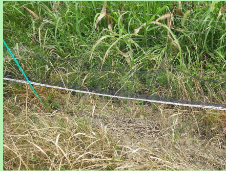
②裾部からの侵入跡 スカート部が掘り出されている
