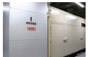
▲非常用発電機
