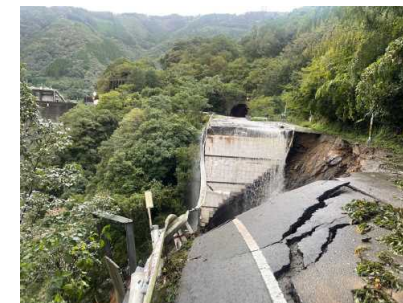
令和4年9月 台風14号により被災した国道327号
