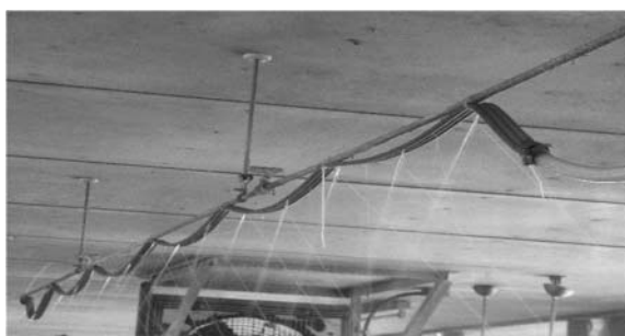
写真2 散水時の散水ホース
