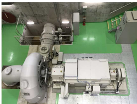
酒谷発電所水車発電機
