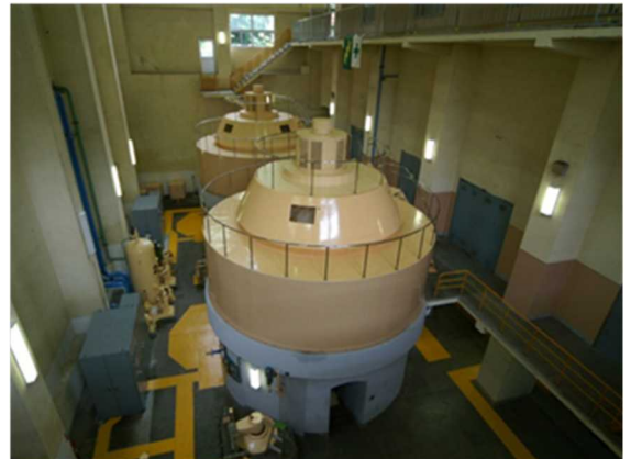
綾第二発電所発電機
