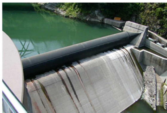
ゴム引布製起伏堰
