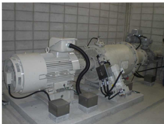
祝子第二発電所水車発電機
