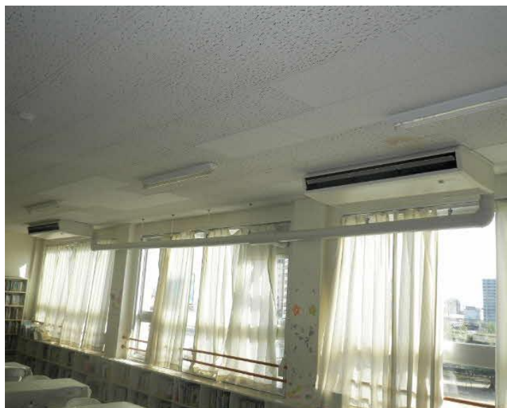
空調整備後の特別教室（岡富小学校）
