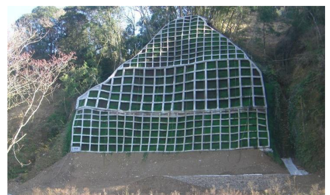
法面工事（宮崎市高岡町浦之名相ヶ谷地区） 施工：春山建設工業（株）
