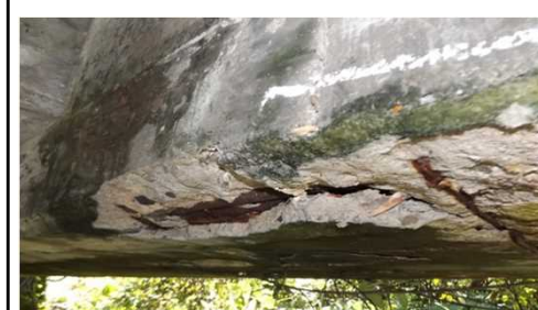
橋梁の老朽化対策（剥離・鉄筋露出）
