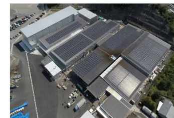
工場屋上の太陽光パネル
