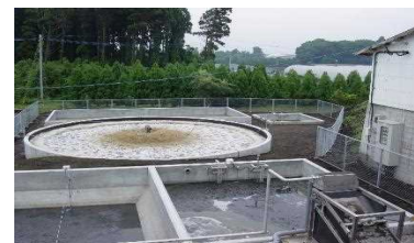
2-(1) 汚水処理施設
