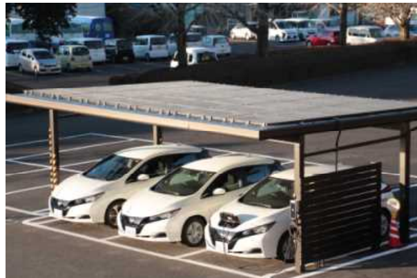
【役場駐車場のEV、ソーラーカーポート等】
