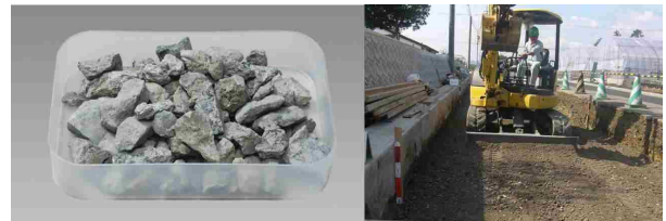
がれき類を破碎して製造された再生クラッシャーランは道路の路盤材などに利用
