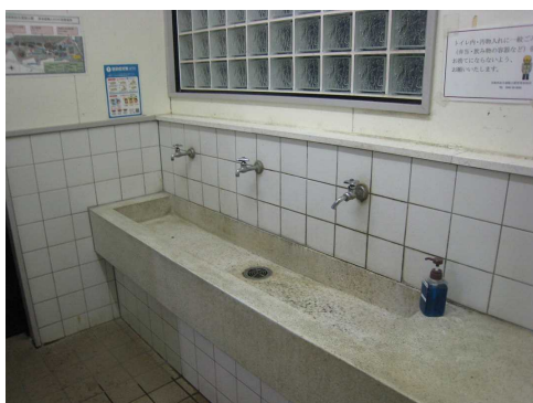
【ひなた宮崎県総合運動公園 手洗場】
