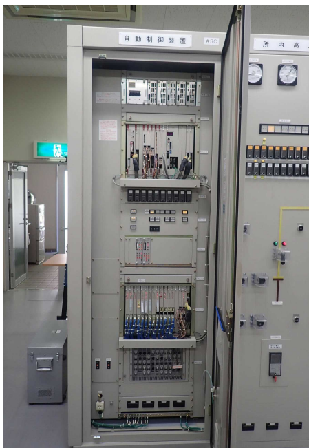
自動制御装置
