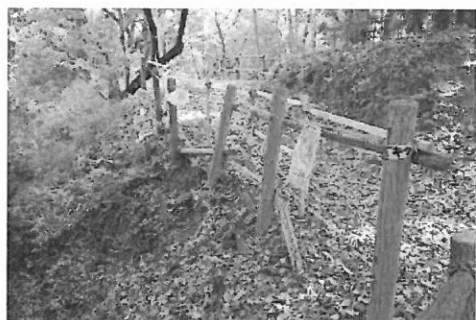
防護柵の老朽化
