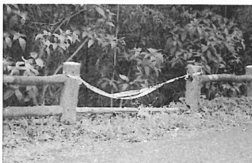
防護柵の破損
