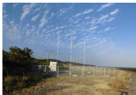
海洋レーダーの設置（日向市）
