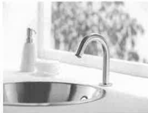
手洗い場の自動水栓化
