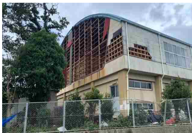
宮崎市立赤江小学校体育館(外壁飛散)
