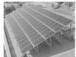
太陽光発電設備
