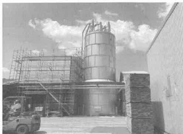
木質ボイラー燃料供給施設
