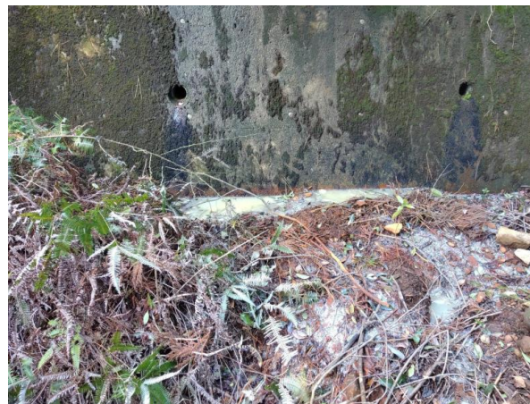
図1 白濁水の漏出状況
