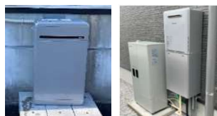
蓄電池 コージェネレーション
