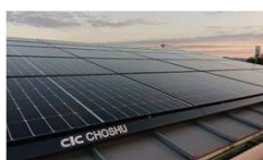
太陽光パネル
