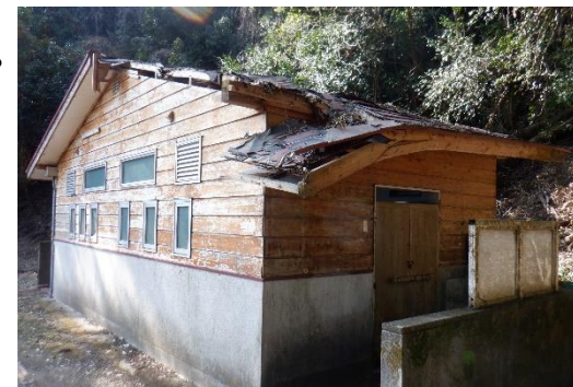
老朽化したトイレ
