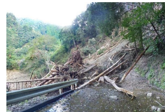
【アクセス道の被害状況】
