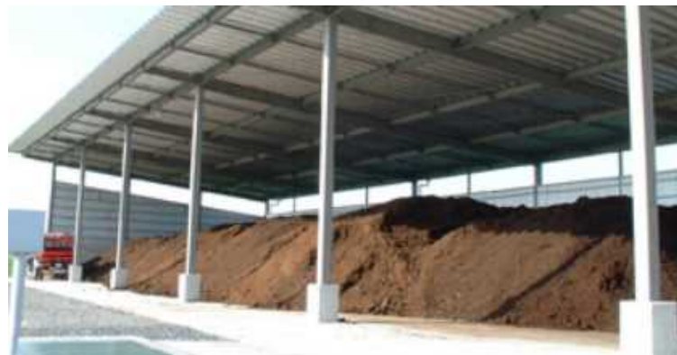
堆肥調整施設
