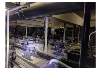
吊物機構(マシン)
