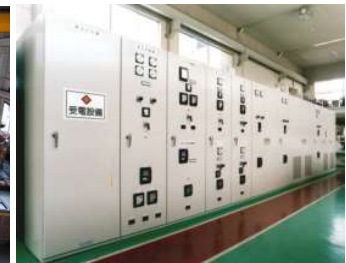
受配電盤・制御盤
