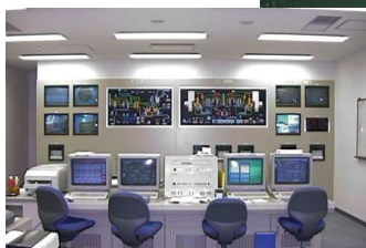
中央監視制御システム
