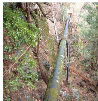
登尾地区の管水路
