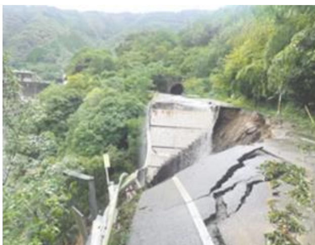
(令和4年 台風第14号による被害)
