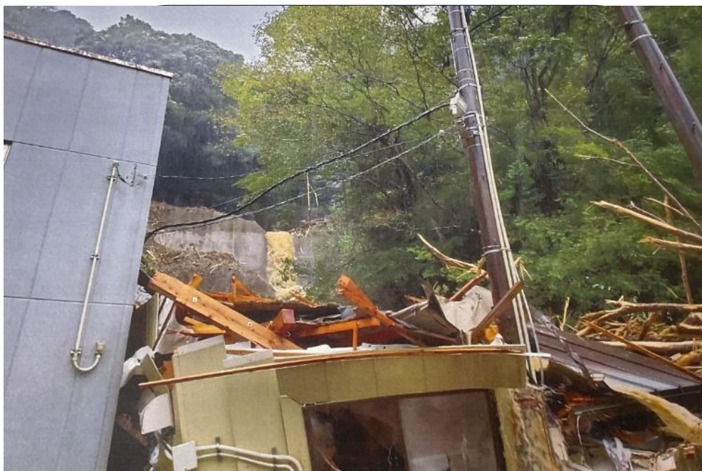
椎葉村 間柏原発電所の事務所兼倉庫が被災
