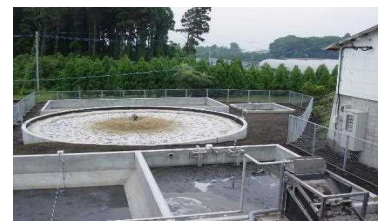
2-(1) 汚水処理施設
