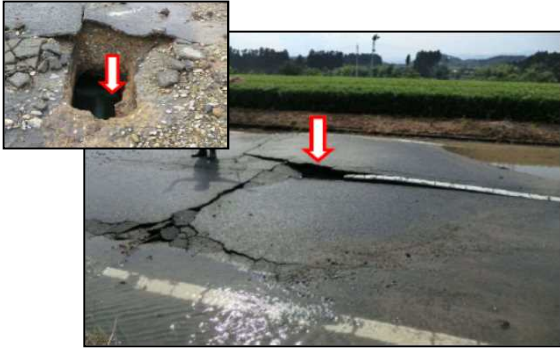
パイプライン漏水による道路被災状況
