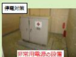
非常用電源の設置
