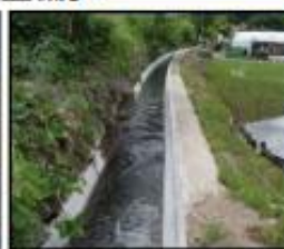
老朽化した用水路の整備・更新
