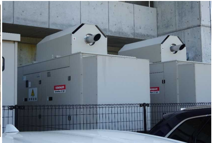
現状の自家発電設備(2機)
